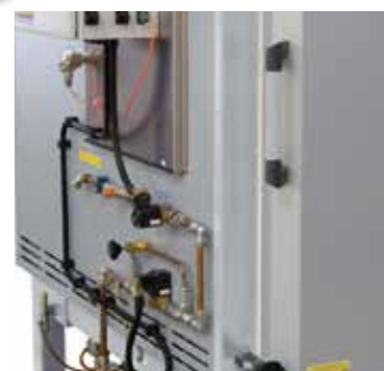
Układ zasilania gazem i termoelement przy piecu
